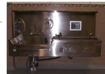
Estación de Disección (Estación de autopsia) (1)
