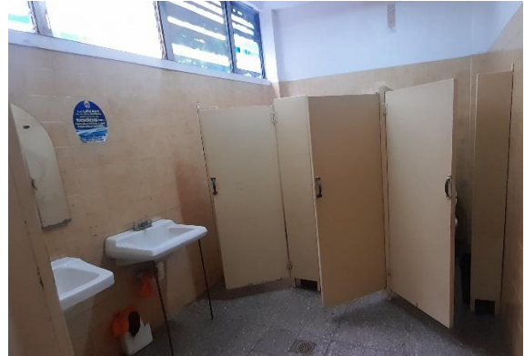
Fotografía N° 2. Módulo Sanitario de Mujeres, Primer Nivel.
