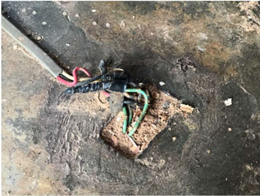
Fotografía 7 Conexión de maquinaria, con cables sueltos.
