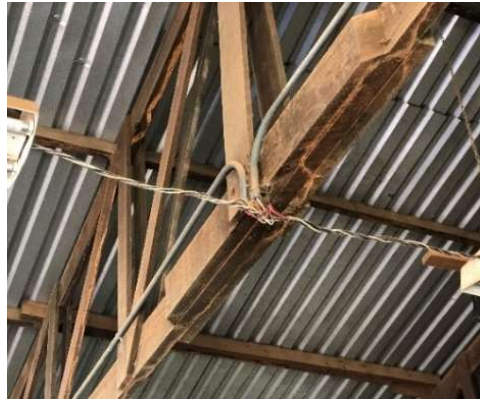
Fotografía 8 Conexión actual de luminarias en Taller de carpintería
