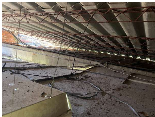
Fotografía 4 Cableado eléctrico expuesto sin tubería y uso de poliducto en algunos tramos, empalmes fuera de cajas de registro.
