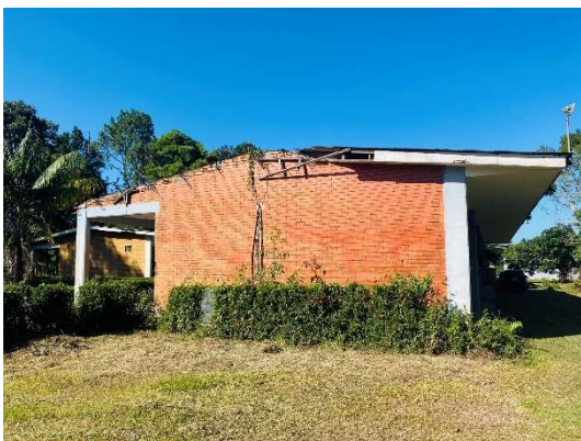
Fotografía 1 Fachada lateral, cubierta de estructura de techo dañada.
