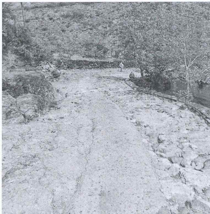
Imagen 6. Huellas existentes en mal estado
