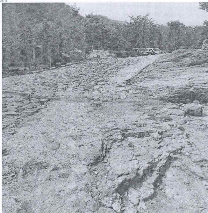
Imagen 5. Huellas Existentes en mal estado
