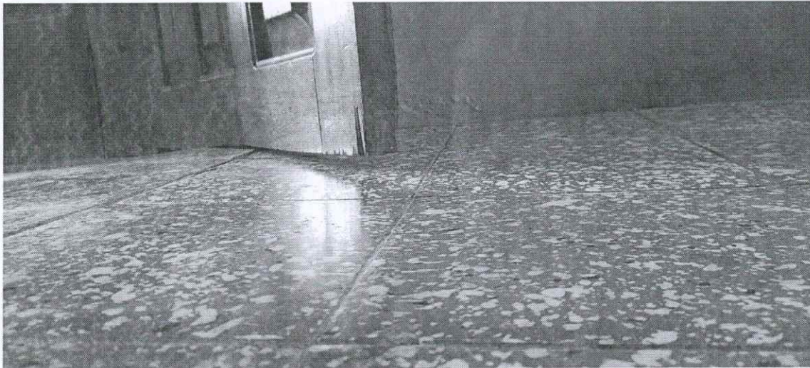
El firme de concreto del piso posee hundimientos.
