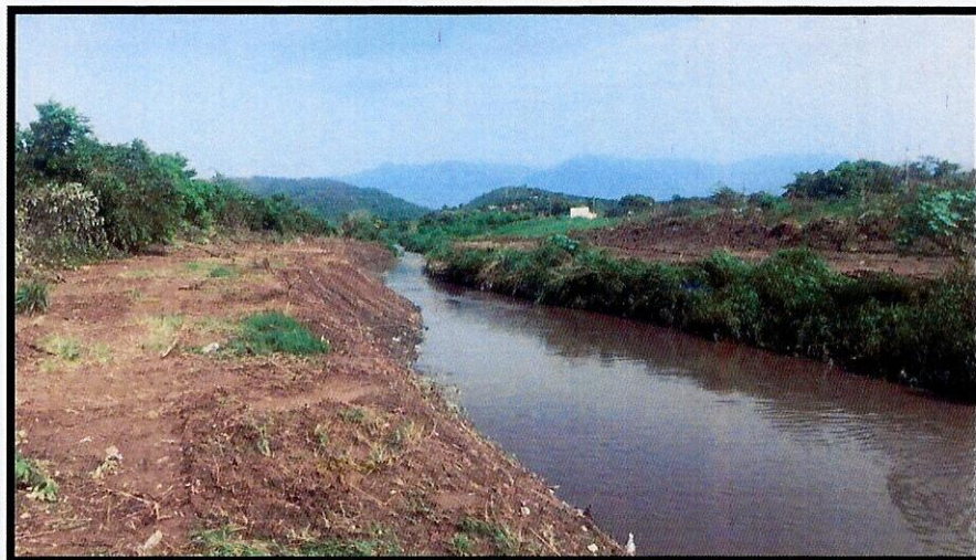
Canal antes de la limpieza
