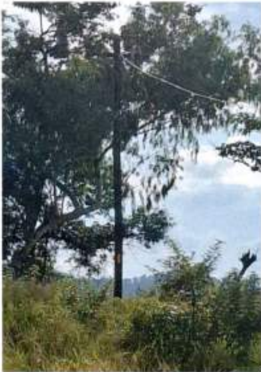
poste a retirar y entregar a la ENEE
