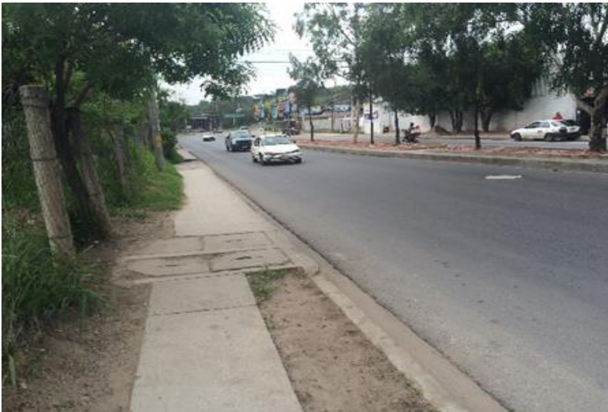
Carretera hacia Fuerza Aerea. Falta de señalamiento vertical y Horizontal
