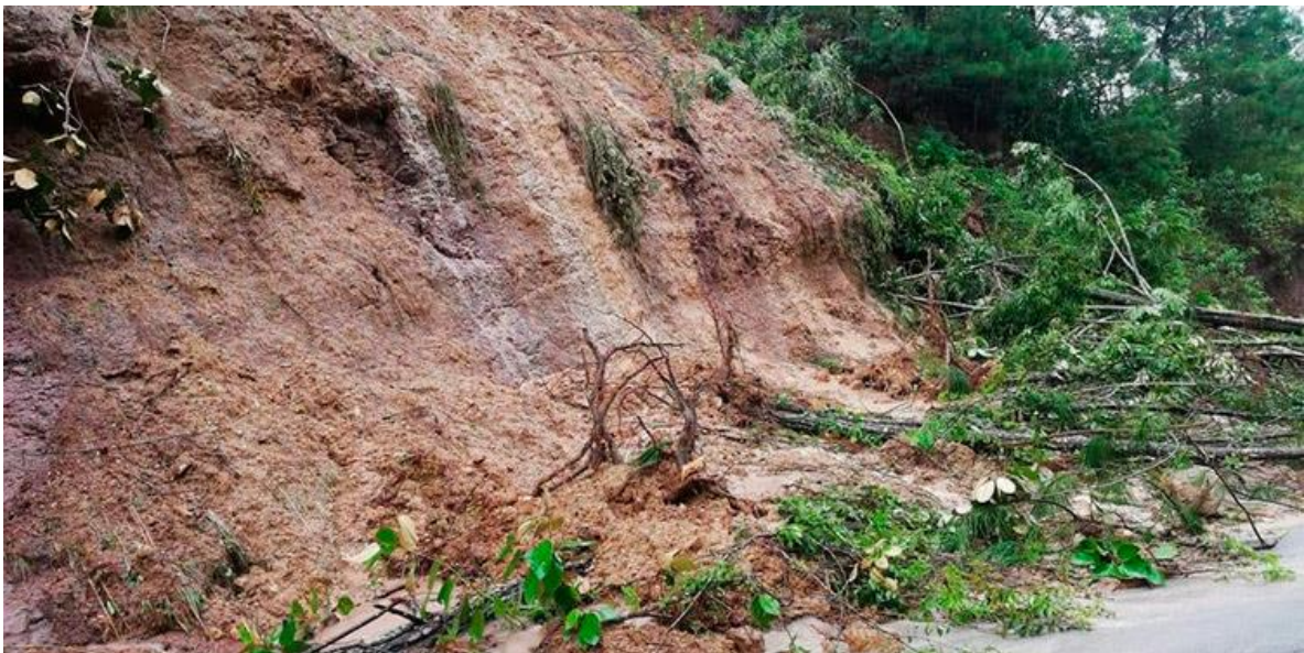
En la imagen se muestra los daños ocurridos por ETA e IOTA en diferentes sitios del Distrito y por ende la necesidad de realizar labores de limpieza para habilitar el tráfico vehicular y peatonal.
