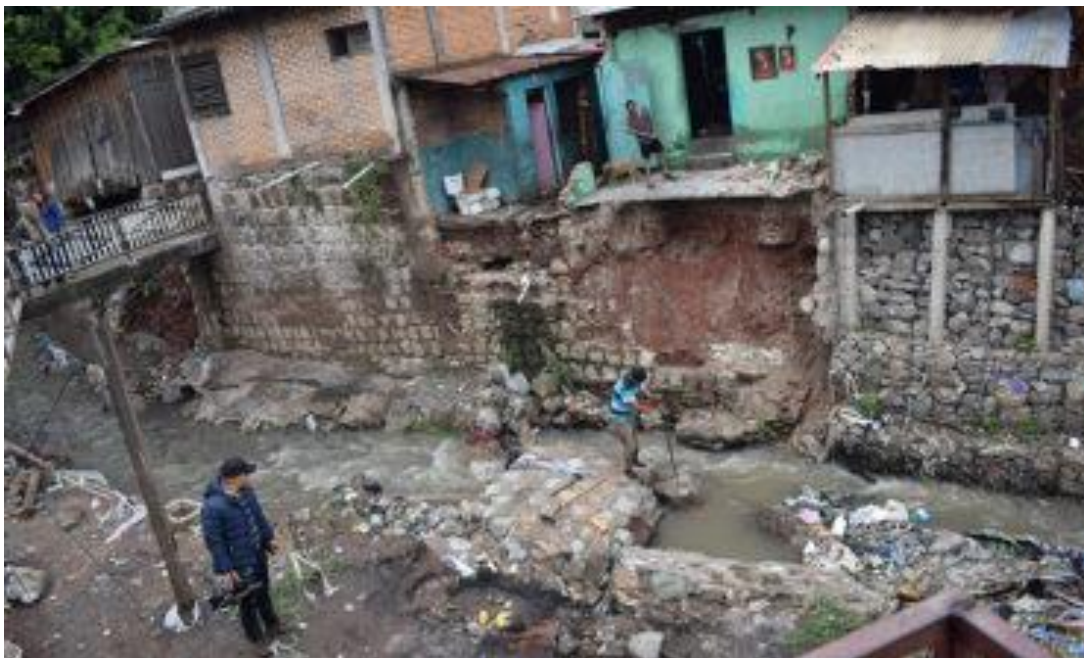
En la imagen se muestra la problemática actual de la quebrada el Sapo
