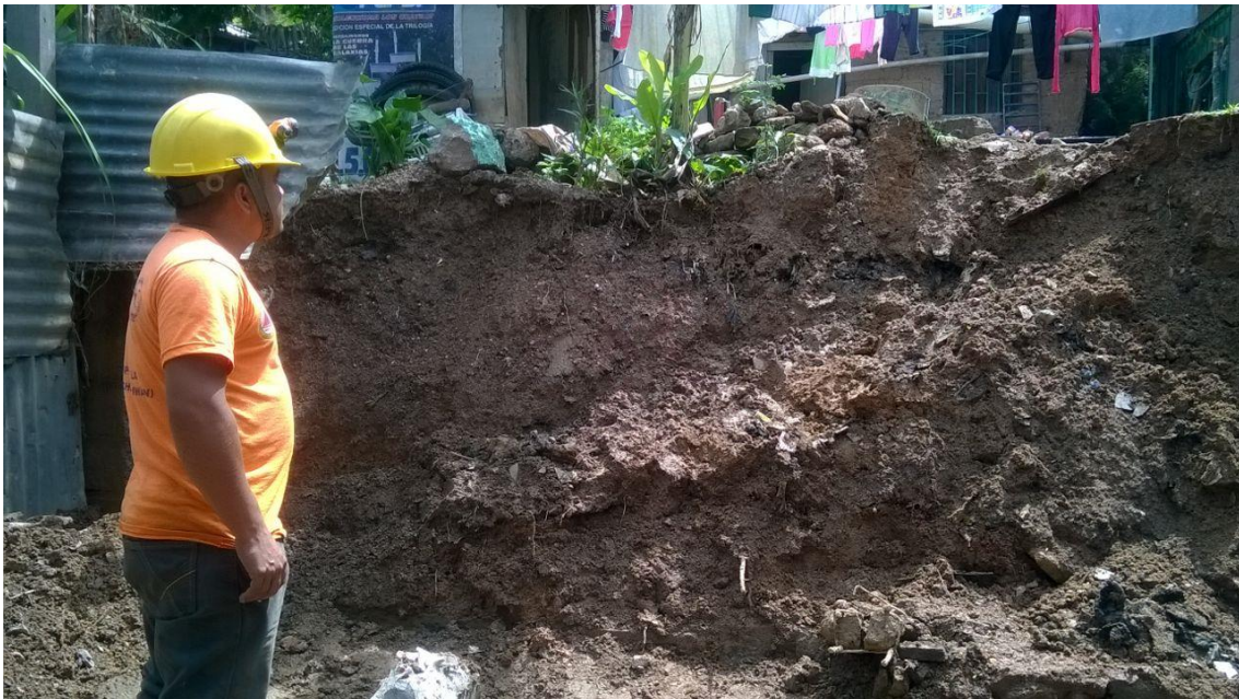
En la imagen se muestra la inestabilidad del suelo de diferentes sitios del Distrito Central
