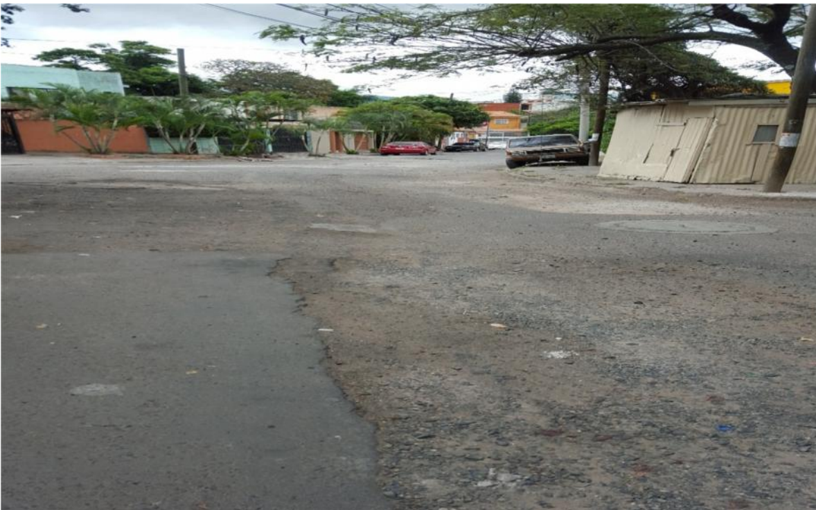
Vista de la calle deteriorada, la cual se rehabilitará
