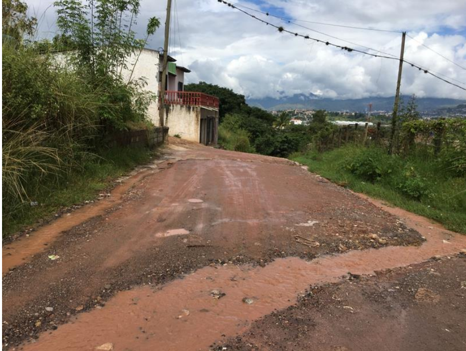
Vista del mal estado de la calle a pavimentar
