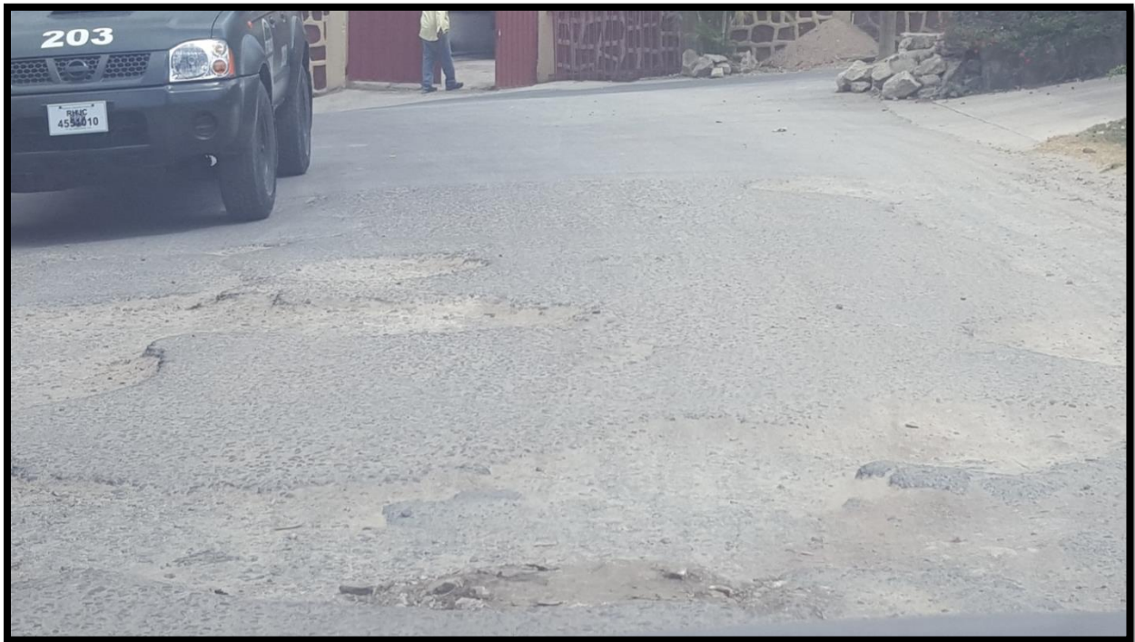
VISTA DEL MAL ESTADO DE LA CALLE
