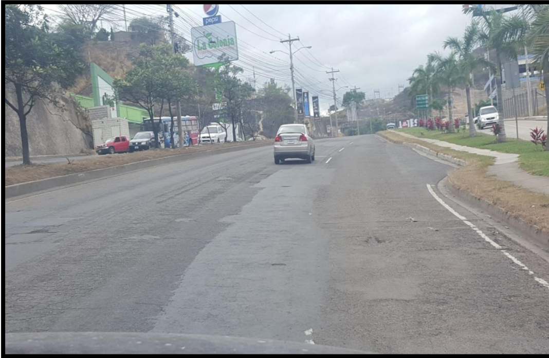
TRAMO EN MAL ESTADO FRENTE A MEGA LARACH
