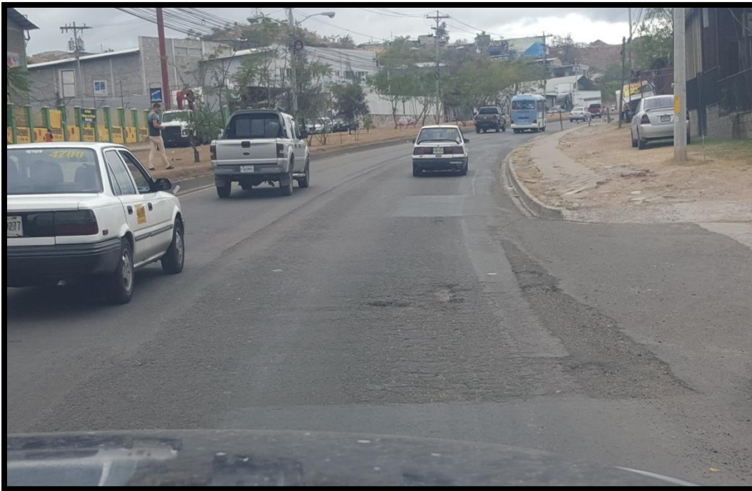
BACHES EXISTENTES EN EL ANILLO PERIFERICO
