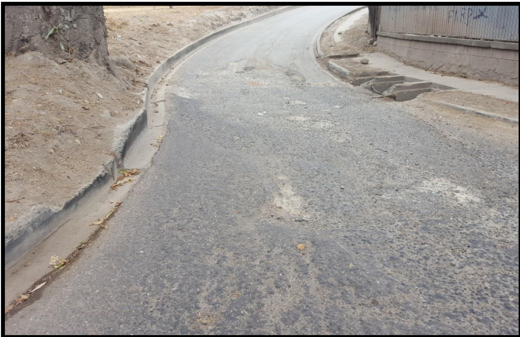
TRAMO EN MAL ESTADO EN EL ANILLO, A LA ALTURA DE LA SALIDA AL SUR
