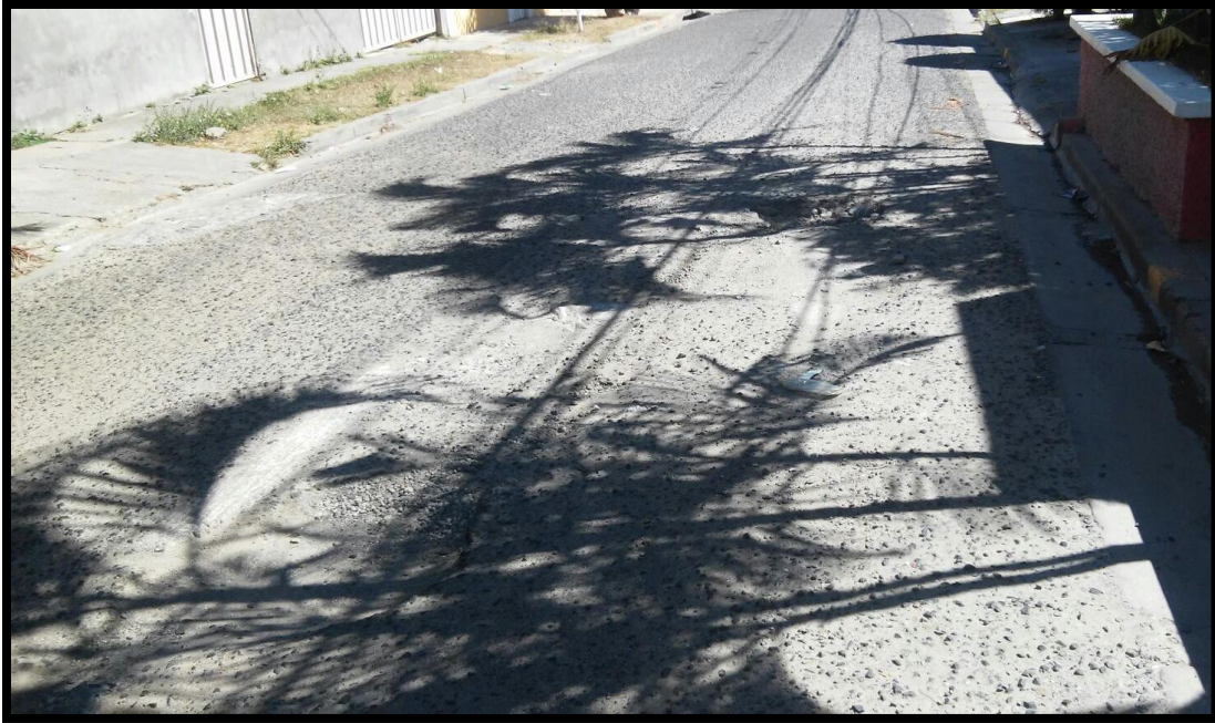
OTRA VISTA DEL TRAMO EN MAL ESTADO
