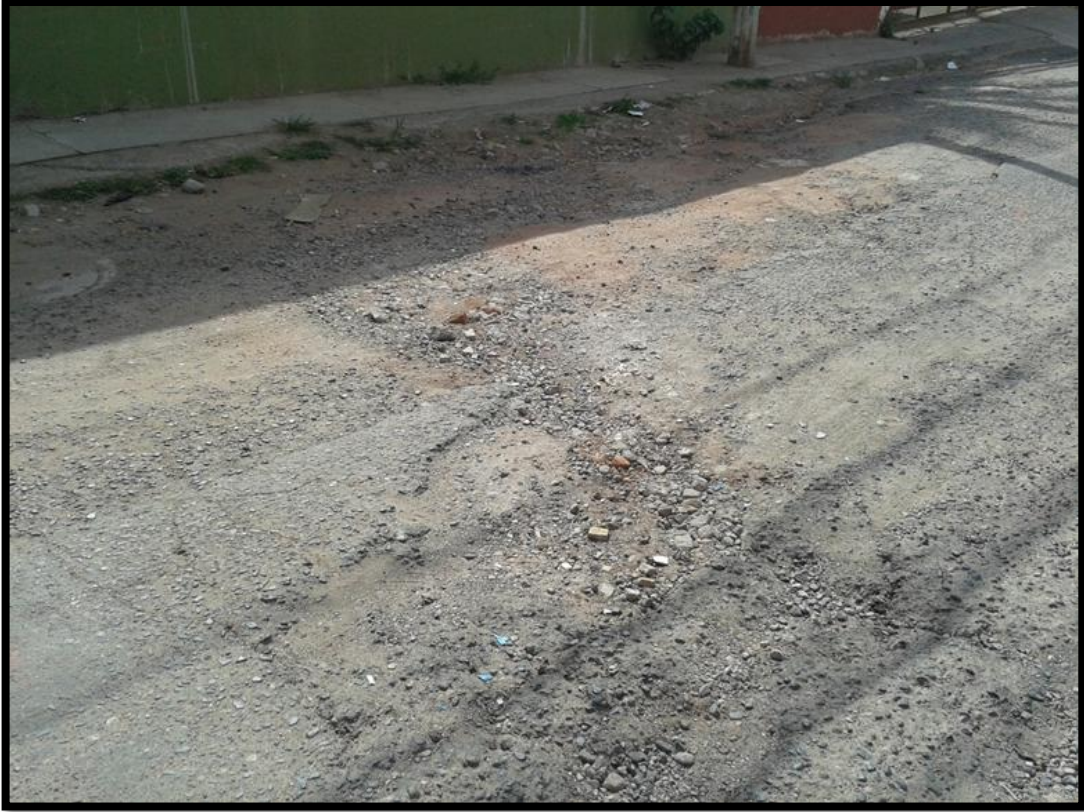
VISTA DESPRENDIMIENTO DE AGRADADOS EN LA CALZADA
