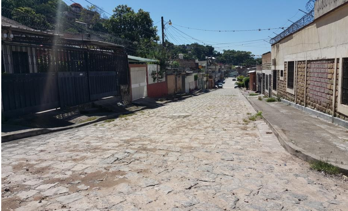
VISTA DE EMPEDRADO A REPARAR
