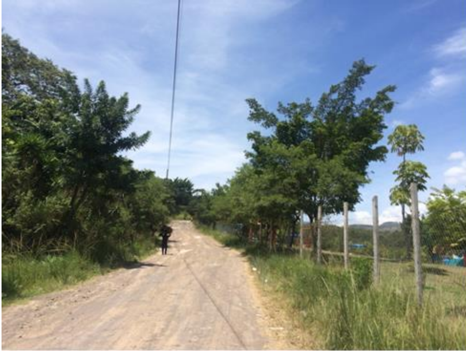
Condiciones actuales de calle a reparar
