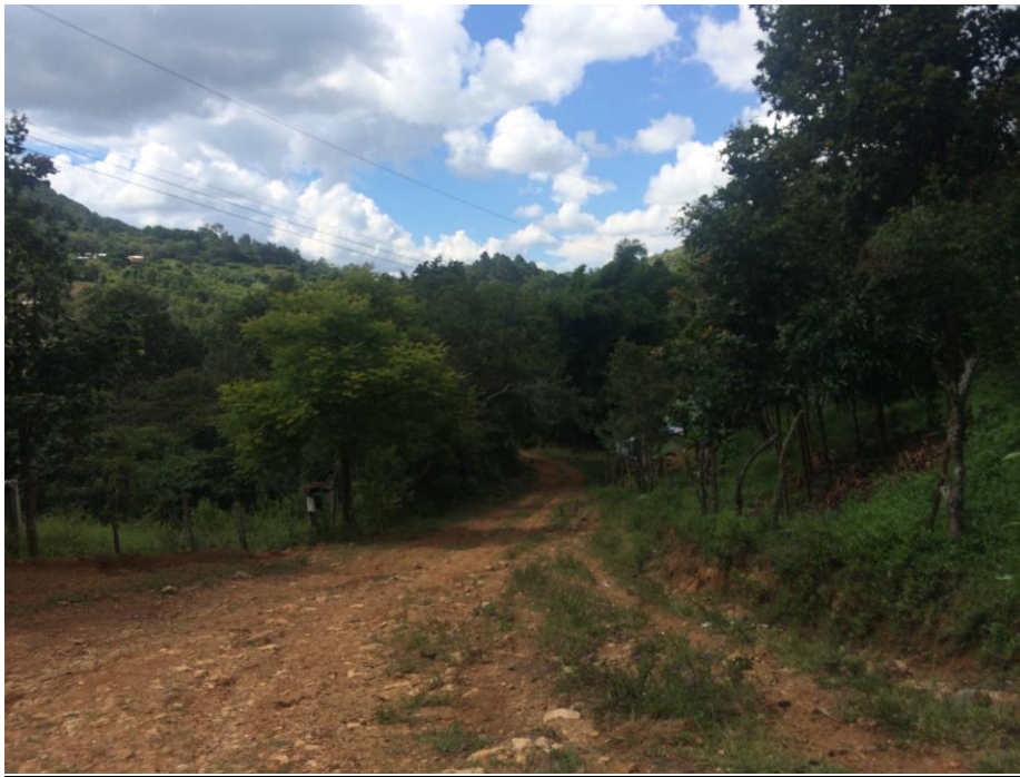
CALLE REQUIERE MECANIZADO Y BALASTADO
