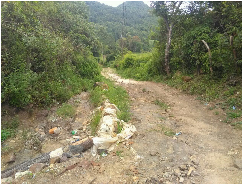
FINAL DE CALLE QUE REQUIERE MECANIZADO Y BALASTADO
