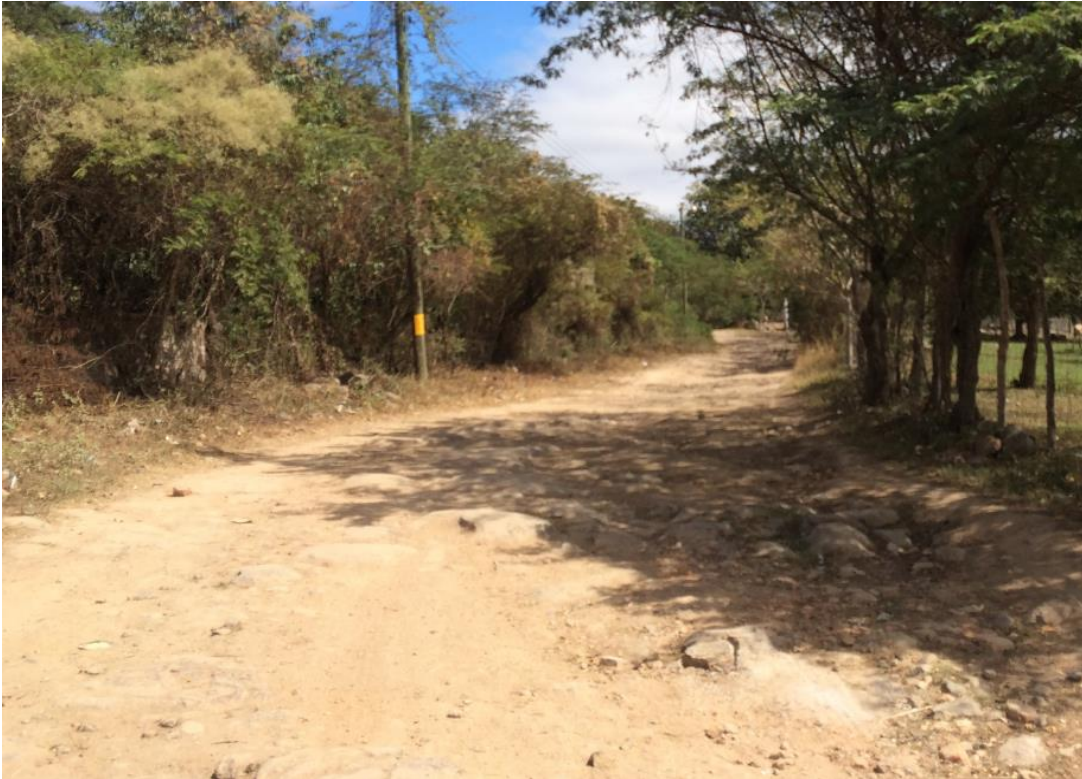
Foto 3 se aprecia la condición actual de la calle por lo que es importante realizar el balastado
