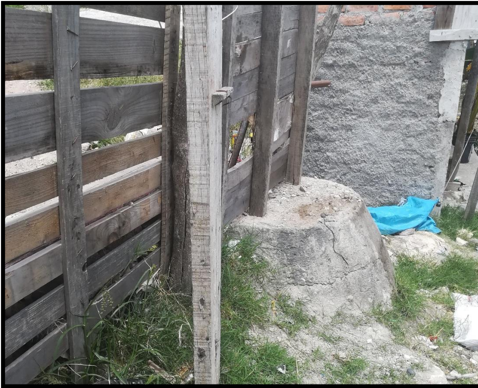
No.3 Los pozo de inspección que se encuentran fuera del limite de calle.
