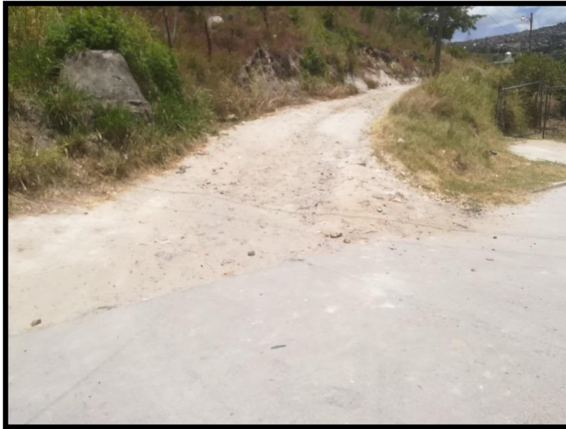
No.1 Inicio de calle a pavimentar, se observa la necesidad del proyecto.
