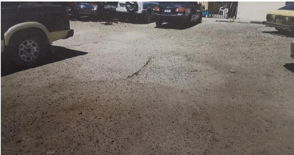
En la imagen se observa las fallas en la superficie de uno de los tramos a rehabilitar con mezcla asfáltica
