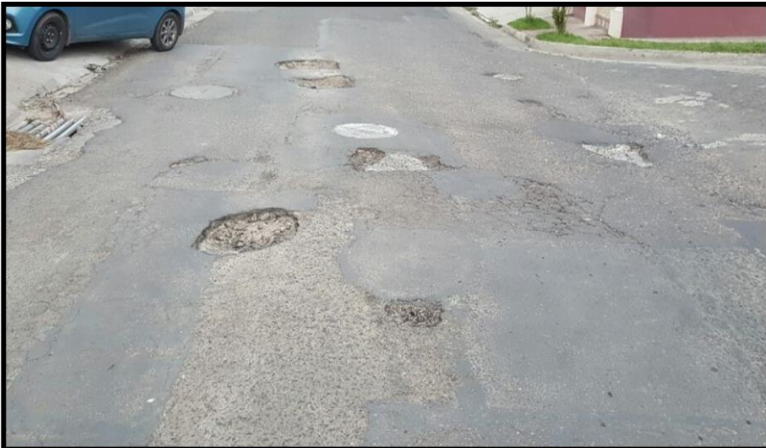
Vista del mal estado de la calle
