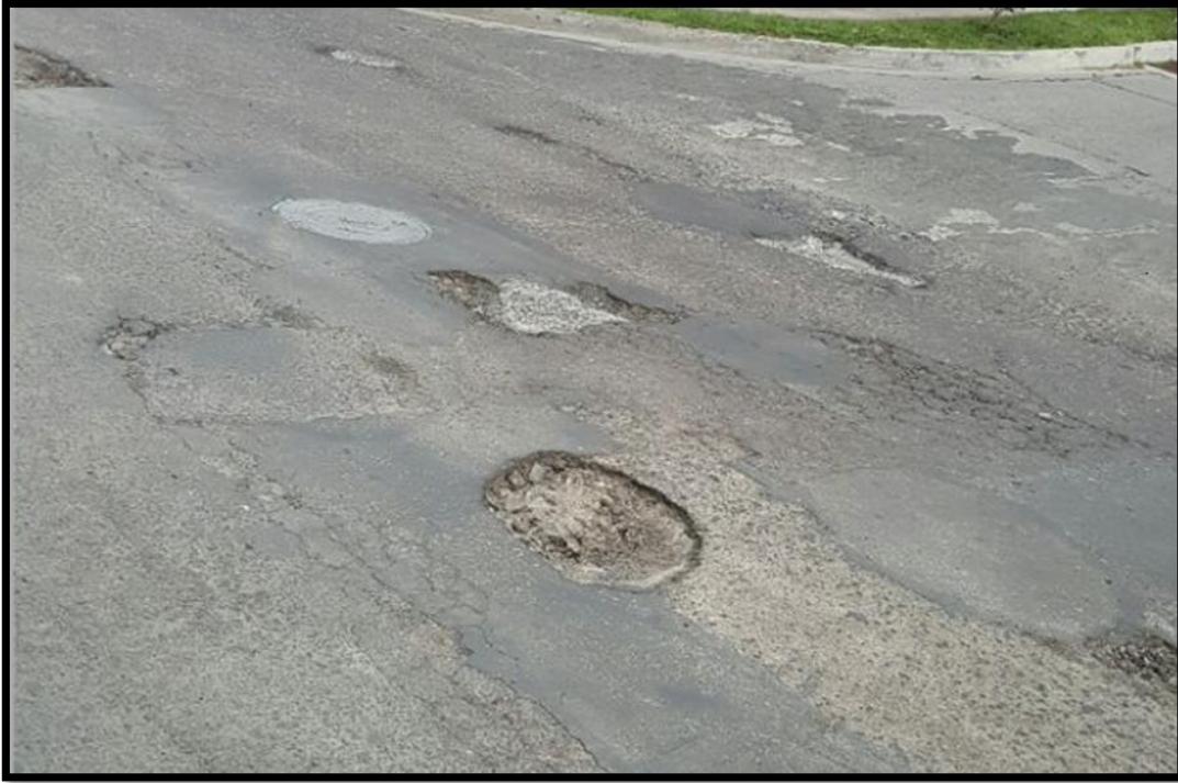
Vista del mal estado de la superficie de rodadura
