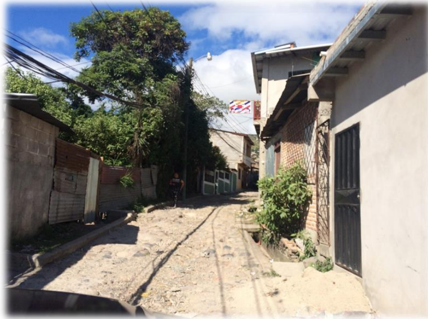
INICIO DE CALLE A PAVIMENTAR CON CONCRETO HIDRÁULICO Y RESIDUOS DE MAMPOSTERÍA A DEMOLER
