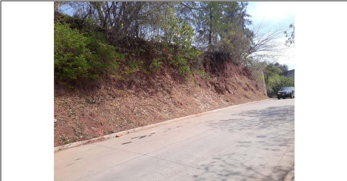
No. 1 Proyecto: CONSTRUCCIÓN DE MURO DE CONTENCIÓN Y OBRAS VARIAS EN CLINICA PERIFERICA (CLIPER), COL. HATO DE ENMEDIO Fecha: FEB 2020 VISTA DEL ESTADO ACTUAL, INICIO DEL MURO DE CONTENCIÓN
