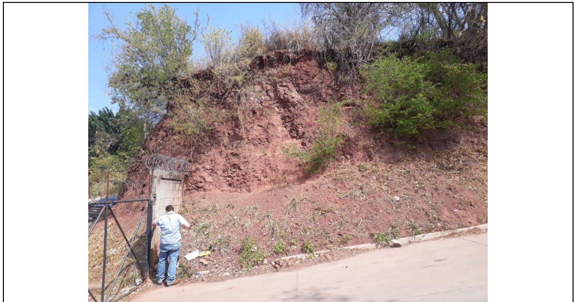
No. 2 Proyecto: CONSTRUCCIÓN DE MURO DE CONTENCIÓN Y OBRAS VARIAS EN CLINICA PERIFERICA (CLIPER), COL. HATO DE ENMEDIO Fecha: FEB 2020 VISTA DEL ESTADO ACTUAL, TIERRA SUELTA EN ACCESO PRINCIPAL
