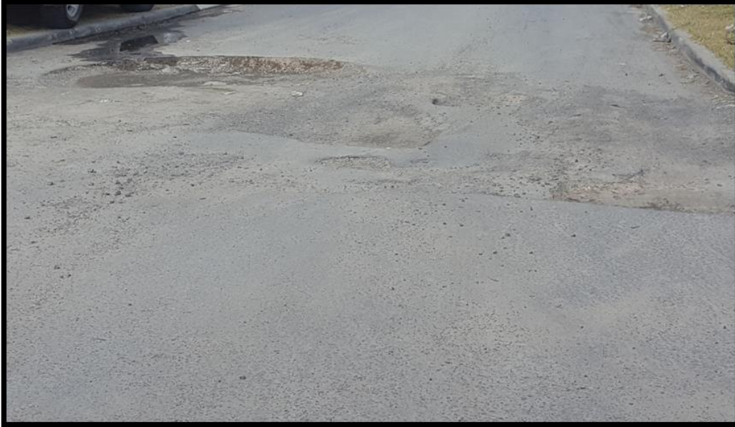
Vista del deterioro de la calle existente
