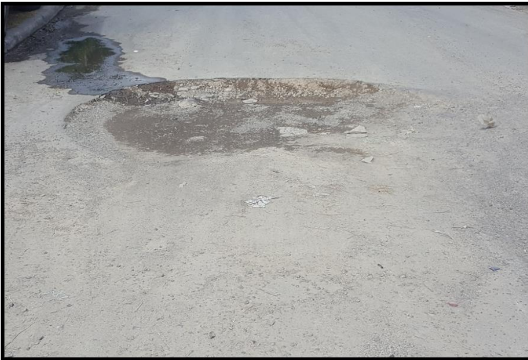
Vista del tramo en mal estado de las calles
