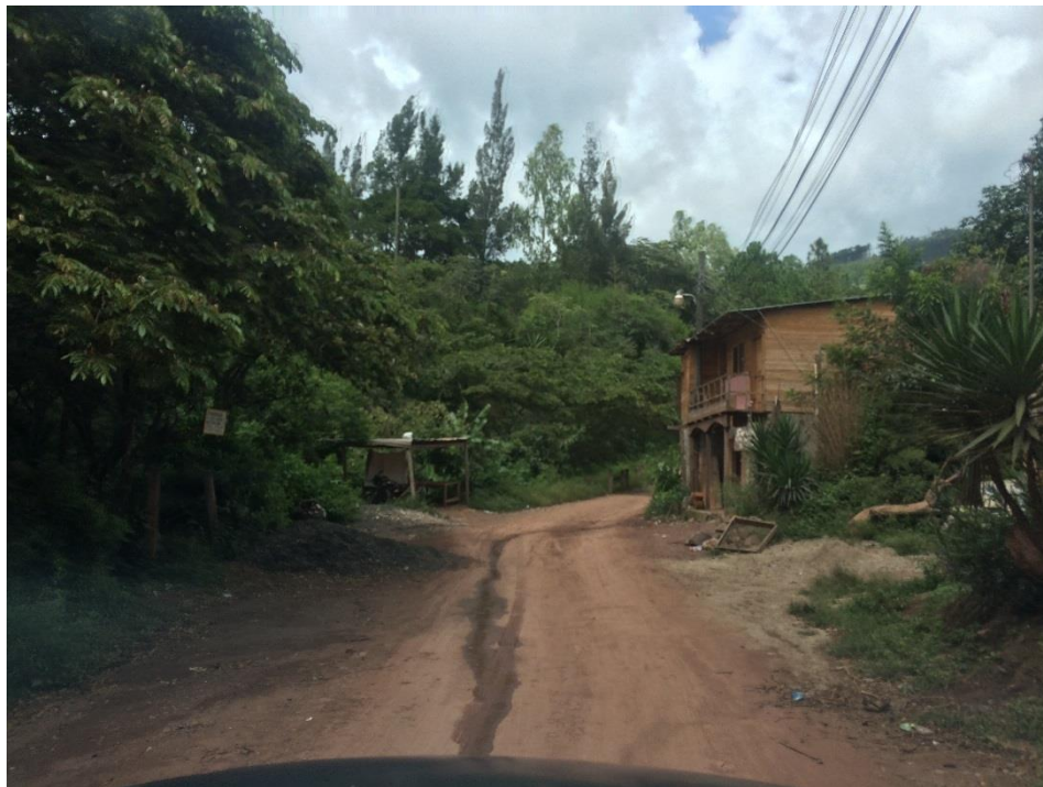
VISTA PANORÁMICA DE CALLE A REPARAR
