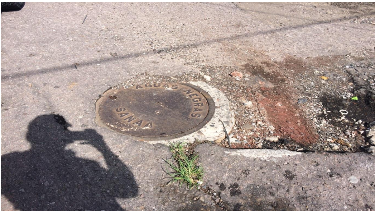
Vista que muestra el pozo de aguas negras y el mal estado de la calle
