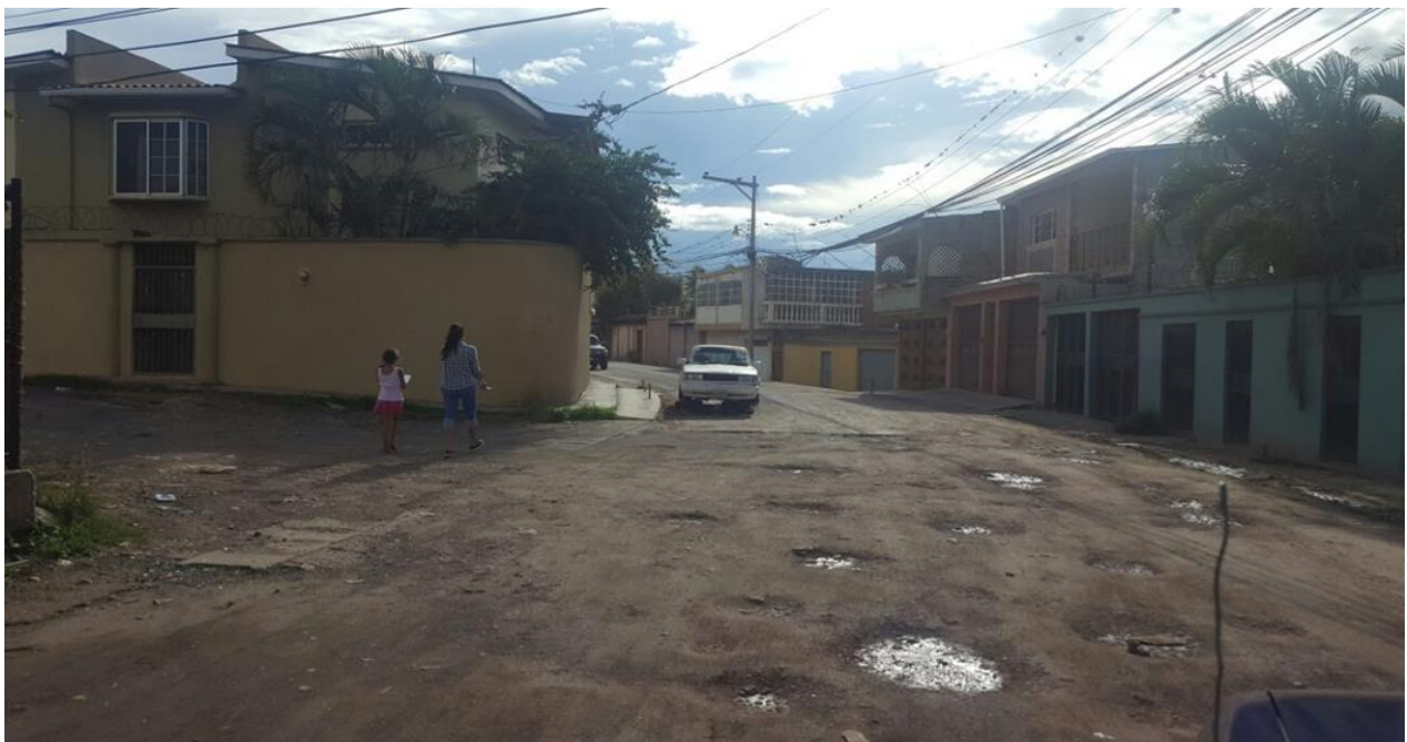
PANORAMA DEL MAL ESTADO DE LAS CALLES A PAVIMENTAR CON CONCRETO HIDRÁULICO
