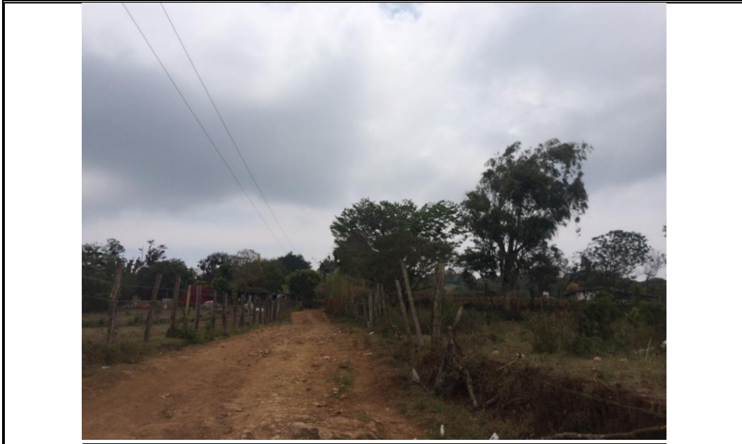
Tramo de calle que se encuentra casi intransitable
