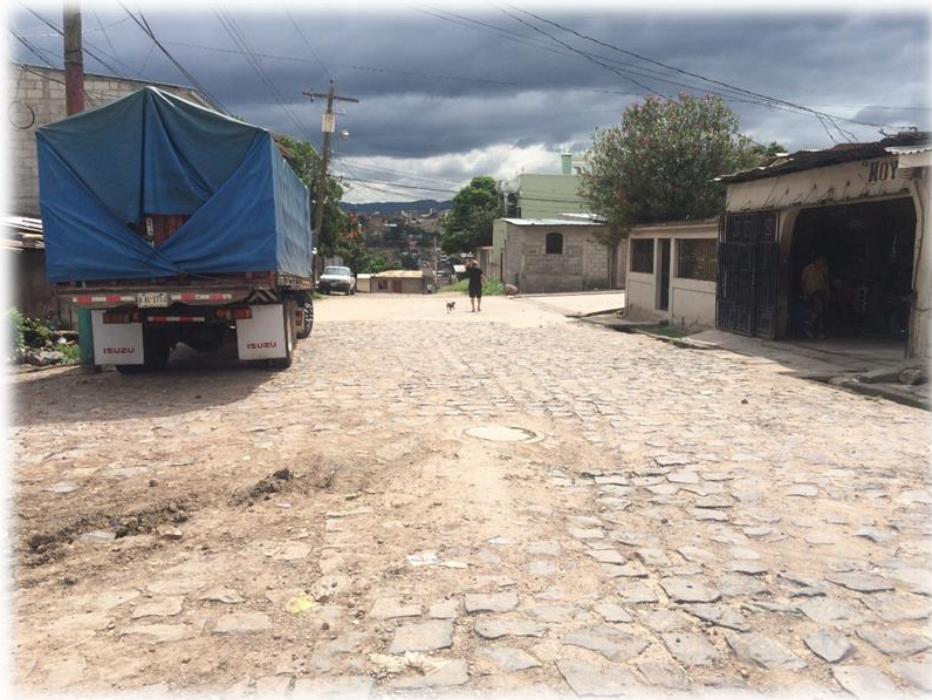
EMPEDRADO A REPARAR
