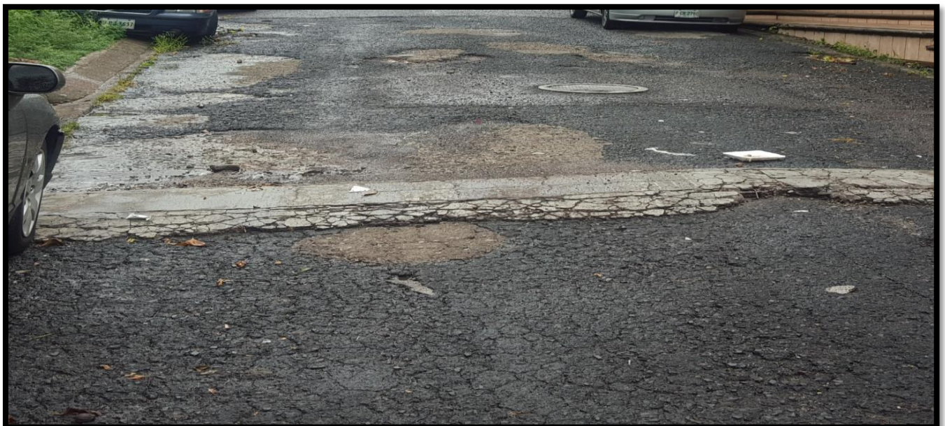
VISTA DEL MAL ESTADO DE LA ESTRUCTURA EXISTENTE
