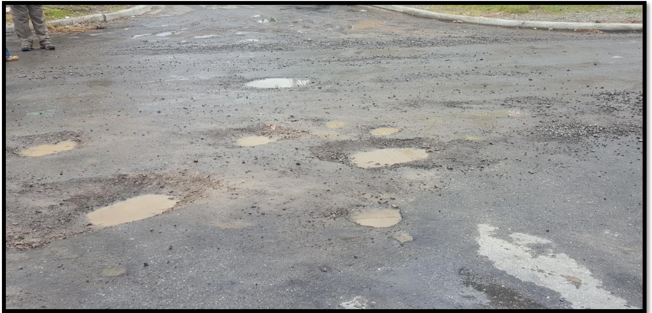
VISTA PANORAMICA DEL TRAMO EN MAL ESTADO
