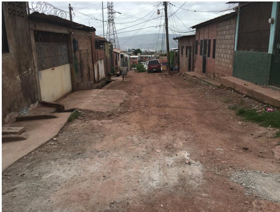
VISTA DE LA CALLE EN MAL ESTADO
