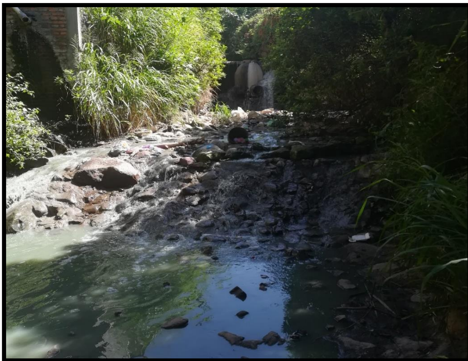
No.2 Para realizar los trabajos se deberá limpiar, desviar y controlar el cauce de la quebrada
