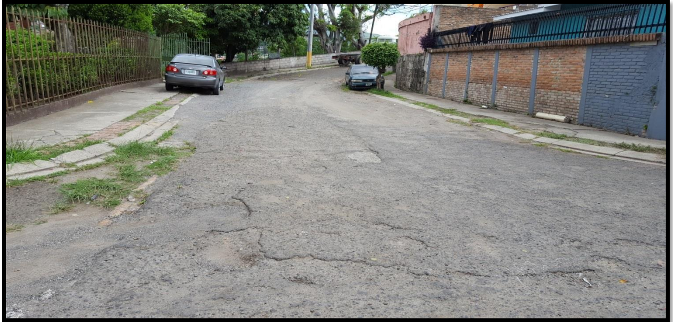
Vista del deterioro de la calle existente
