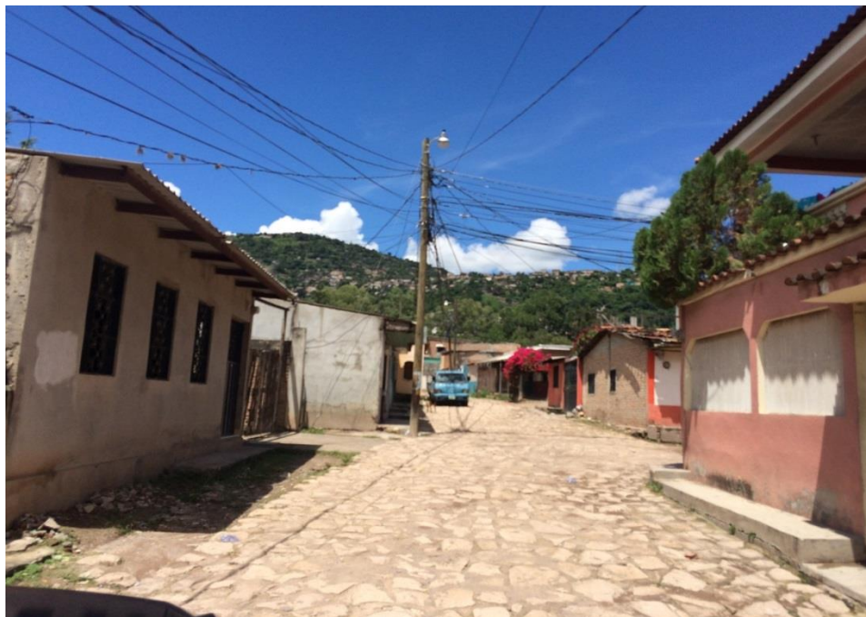
Vista de calle a reparar empedrado y pavimentar con white topping
