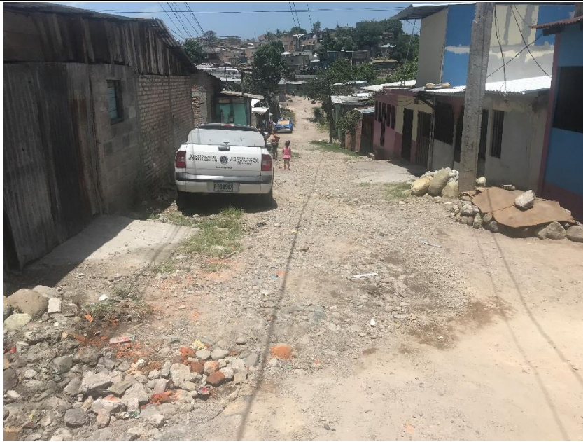
No.1 SE PUEDE APRECIAR LA EROSIÓN EN LA CALLE A PAVIMENTAR
