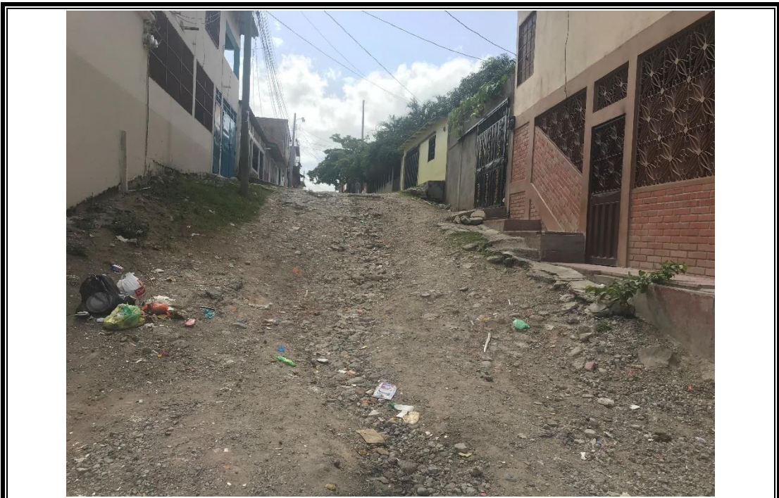
No. 5 VISTA DE LA EROSION QUE SUFRE ESTA CALLE CON LAS LLUVIAS
