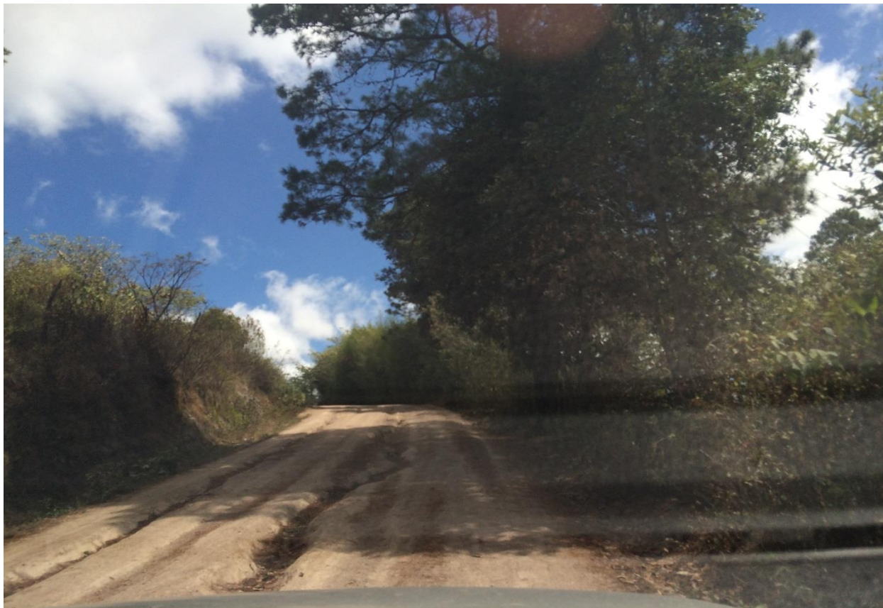
VISTA DE CALLE QUE REQUIERE BALASTADO
