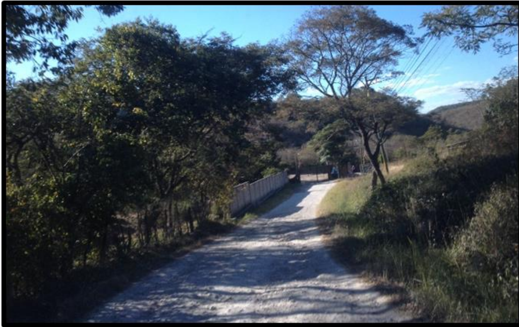
Tramo en mal estado de colonia El Recreo
