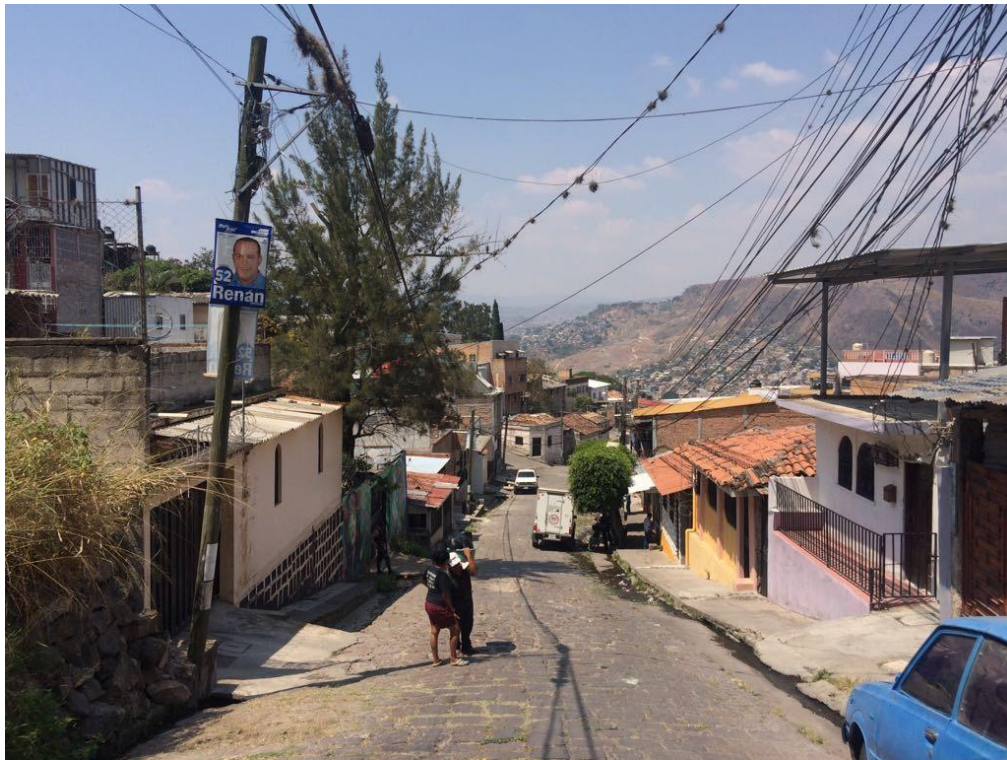
EMPEDRADO EXISTENTE EN MAL ESTADO
