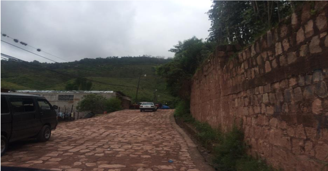
VISTA DE EMPEDRADO A REPARAR
