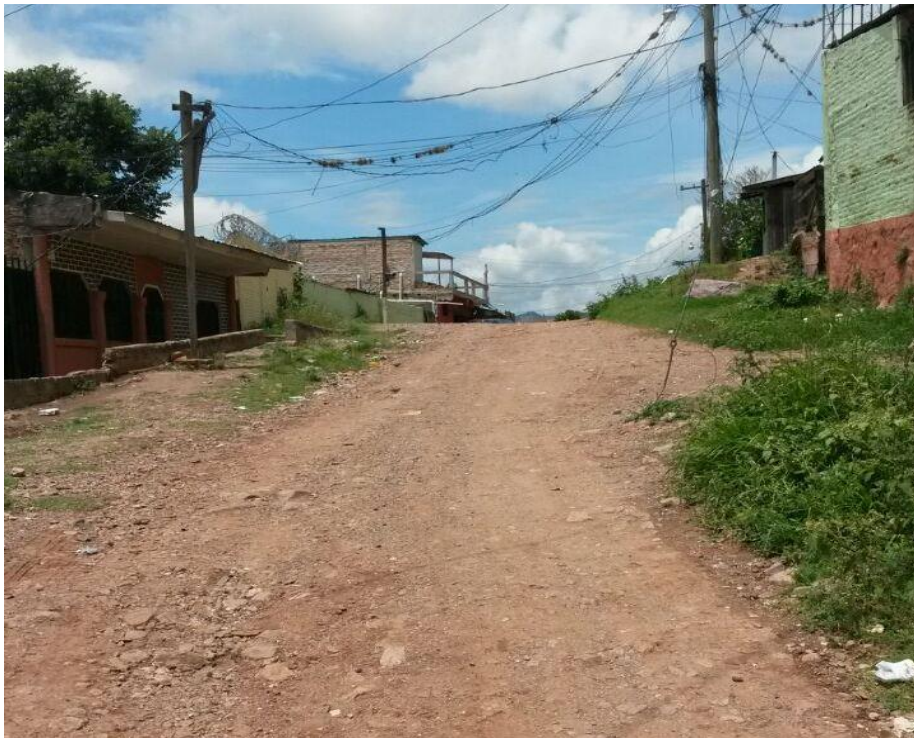
VISTA DE LA CALLE EN MAL ESTADO
