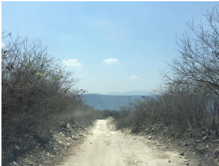
VISTA DEL MAL ESTADO DE UN TRAMO A BALASTAR
