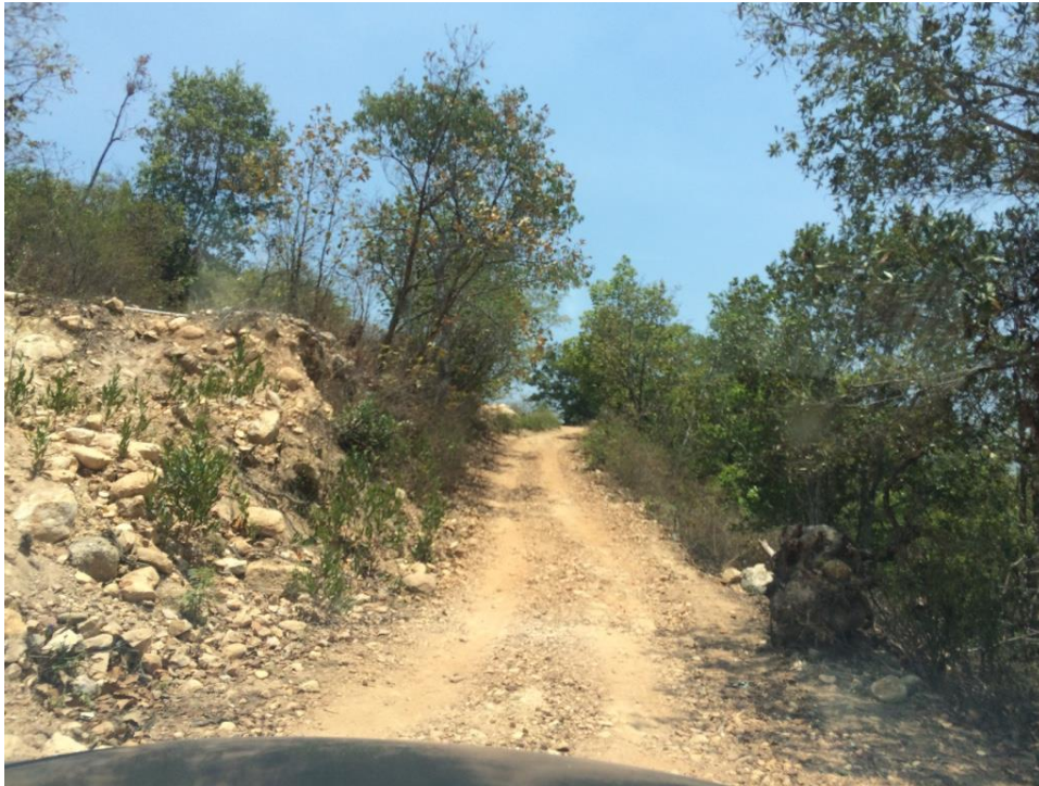
VISTAS DE TRAMOS EN MAL ESTADO
