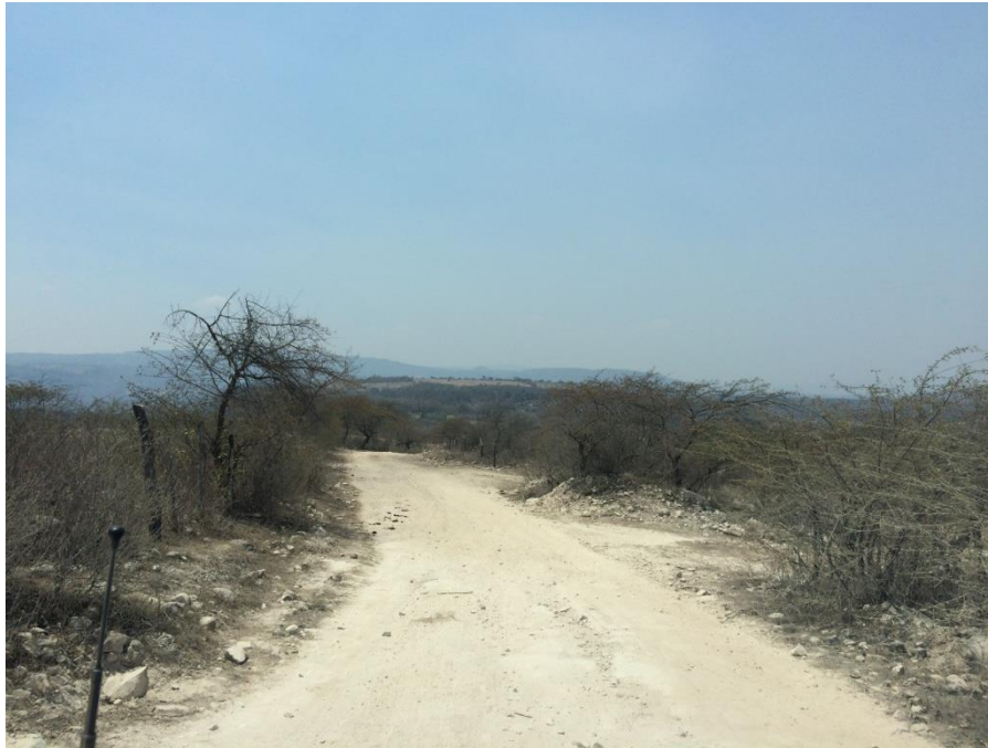
TRAMOS A REPARAR EN ACCESO A SAN JUAN DEL RIO GRANDE
