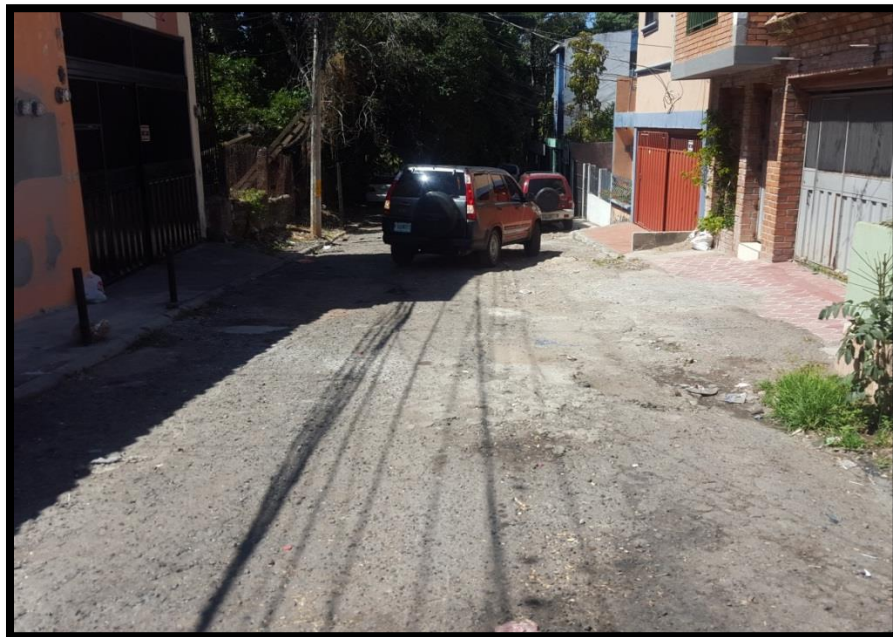
VISTA PANORAMICA DEL TRAMO EN MAL ESTADO
