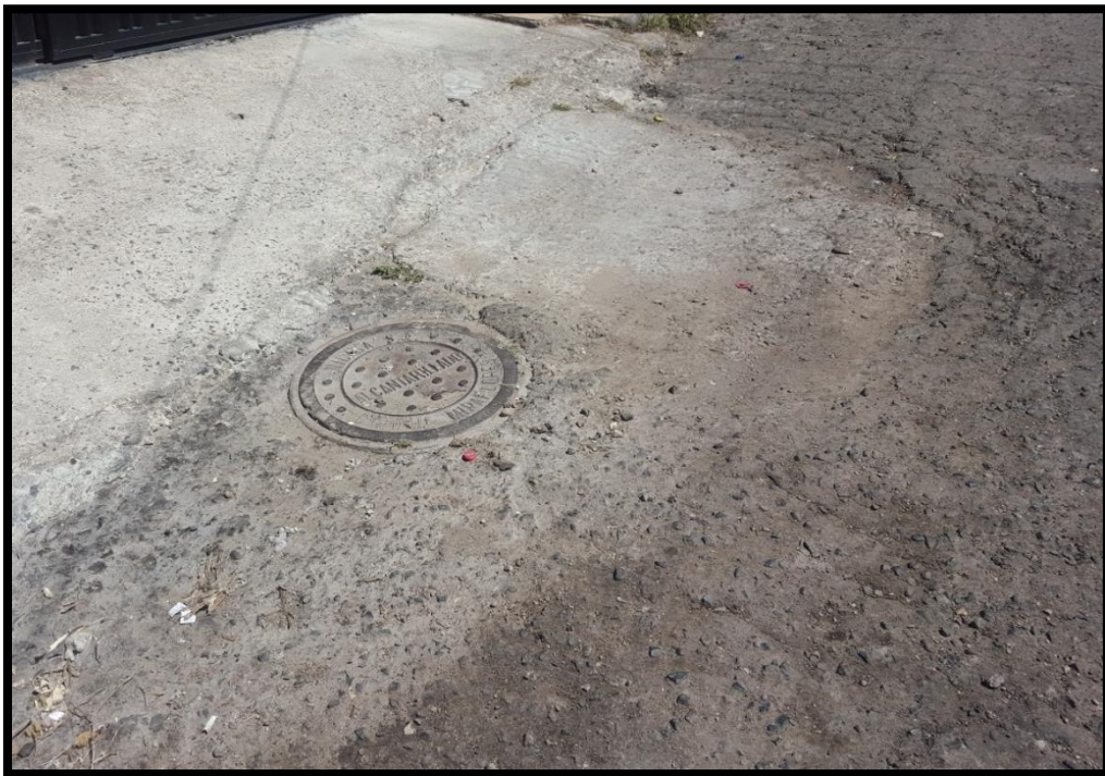
SE OBSERVA EL MAL ESTADO DE LA CALLE Y UNO DE LOS POZOS A NIVELAR
