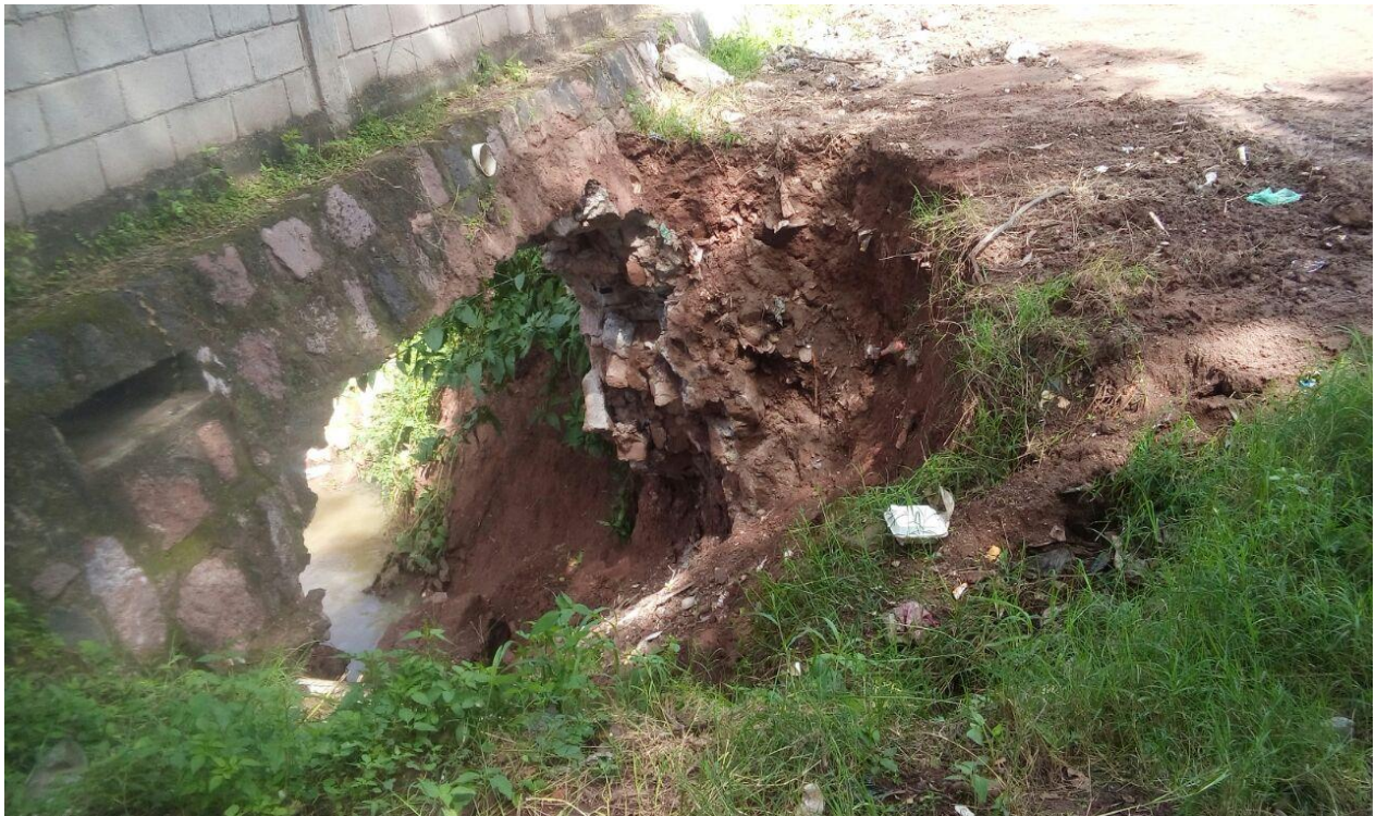
SITUACION ACTUAL DEL MURO
