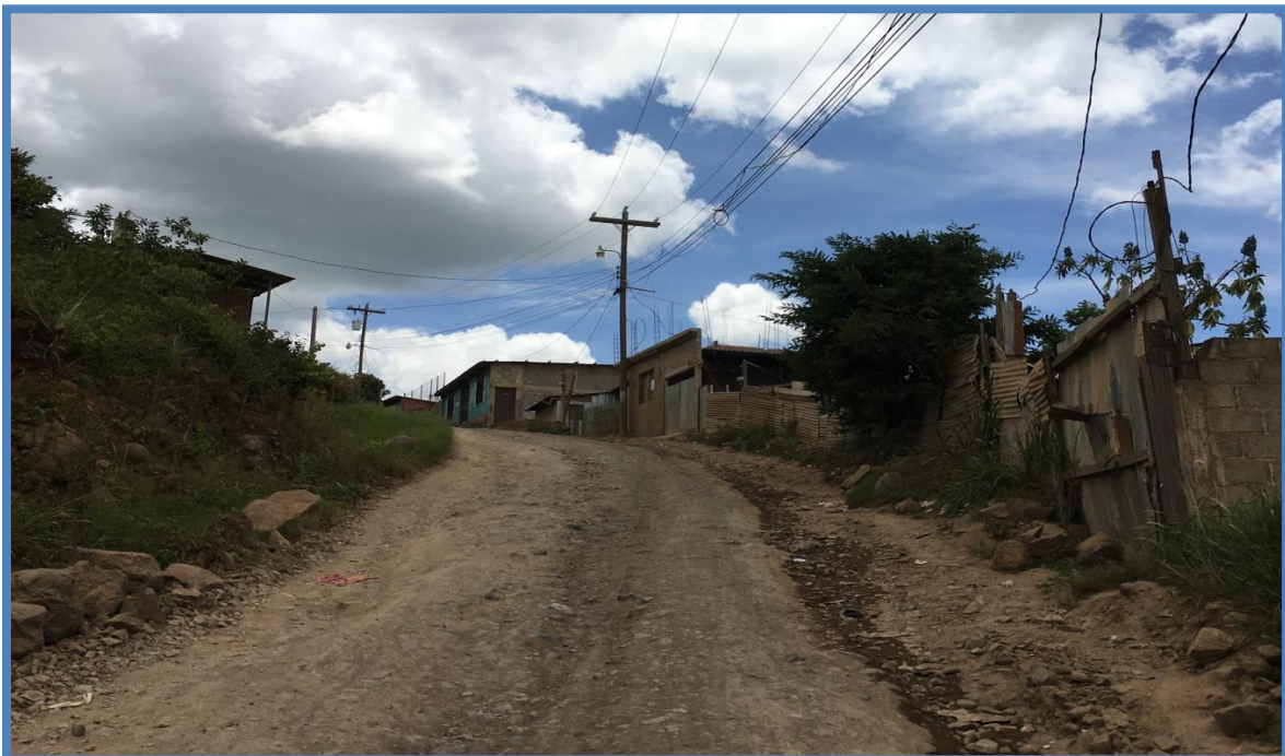
Panorama de los correderos naturales formados por la falta de cunetas
