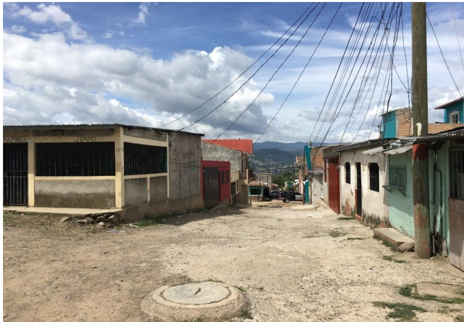
VISTA DE LA CALLE EN MAL ESTADO
