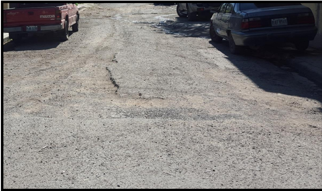
VISTA DEL MAL ESTADO DE LA SUPERFICIE DE RODADURA
