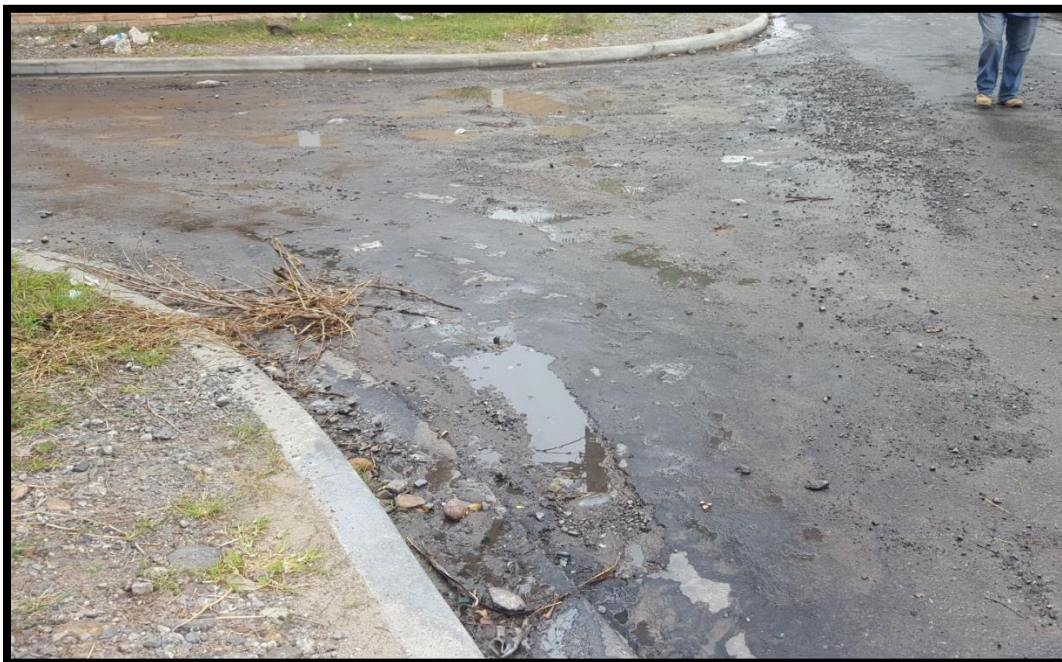
OTRA VISTA PANORÁMICA DEL TRAMO EN MAL ESTADO
