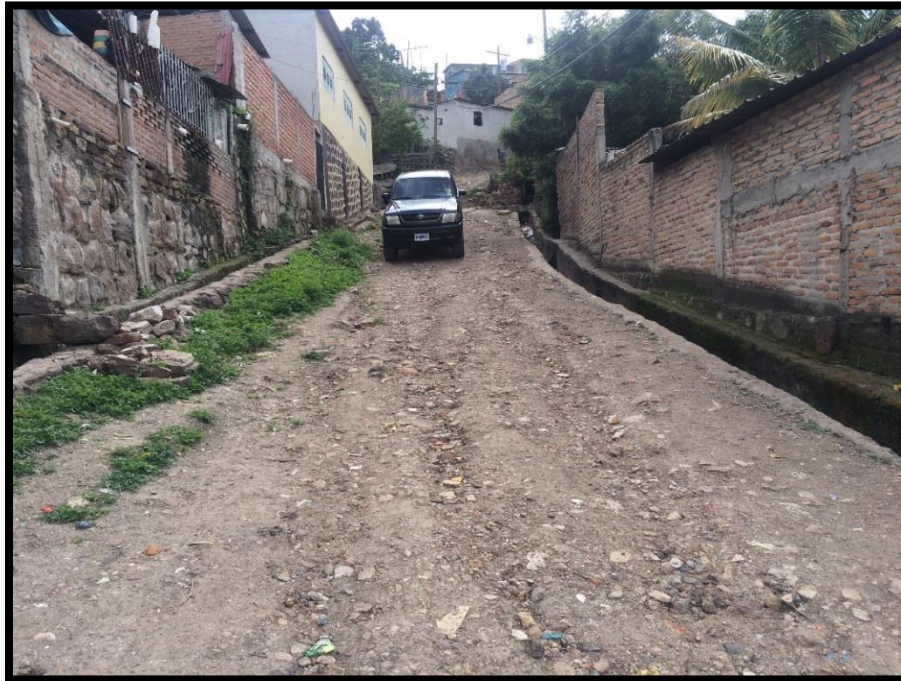
VISTA DEL MAL ESTADO DEL FINAL DE LA CALLE
