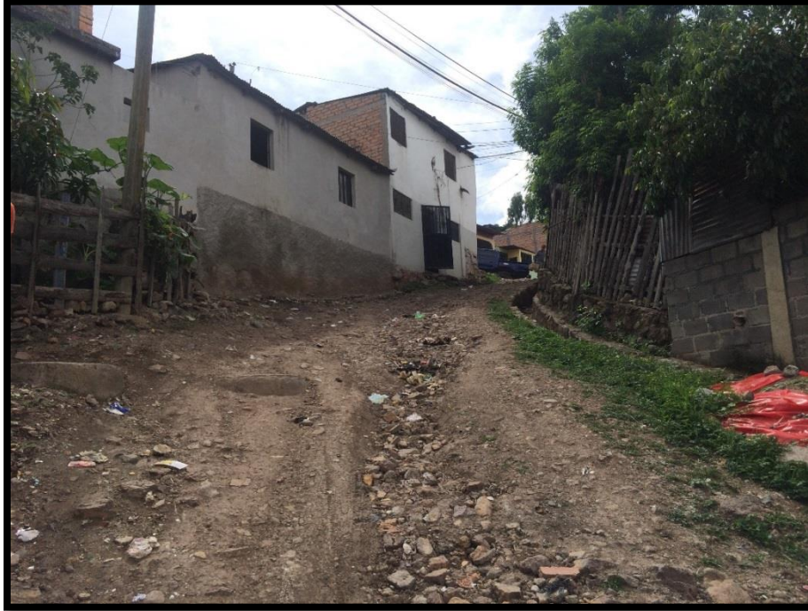
OTRA VISTA DEL MAL ESTADO DE LAS CALLES ACTUALMENTE
